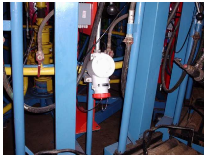
Toma de carga de baterías sobre carrusel
